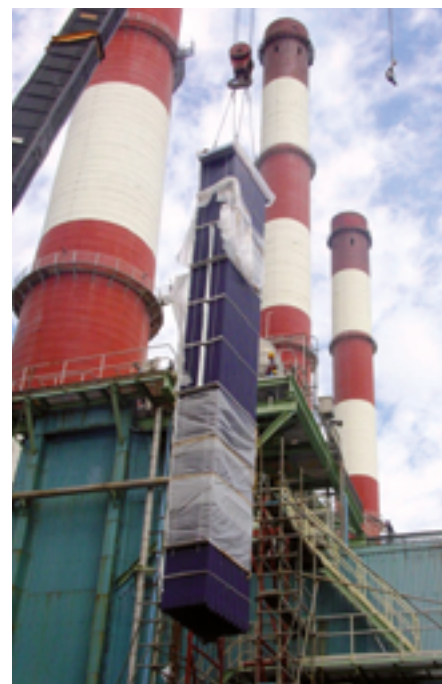
Kraftwerk, 3 Blöcke mit je 500 MW
